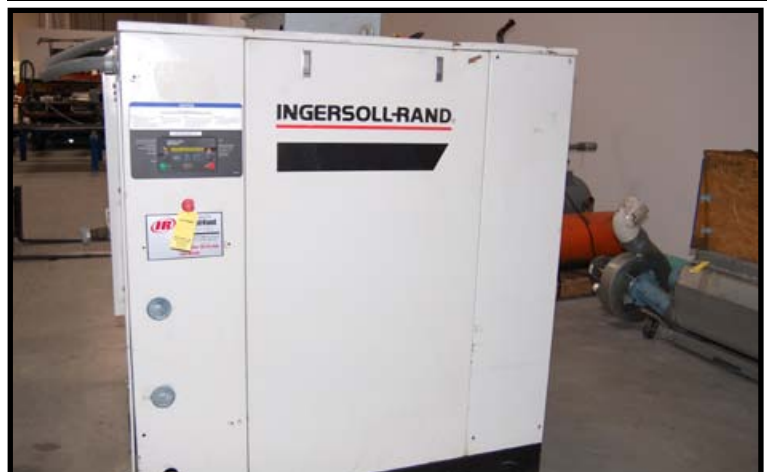
INGERSOLL RAND 100 H.P COMPRESSOR
